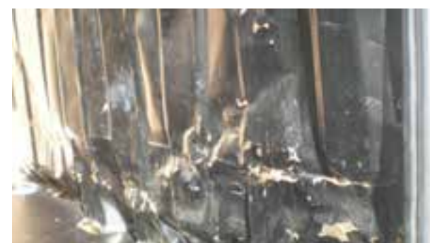
Innvendige deformeringer: Vesentlig deformering, reparasjonstid > 3 h, hull, kutt
