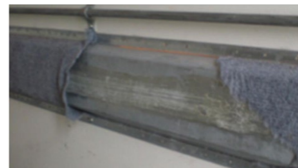
Indtræk og stænger: Revnet eller løst tæppe
