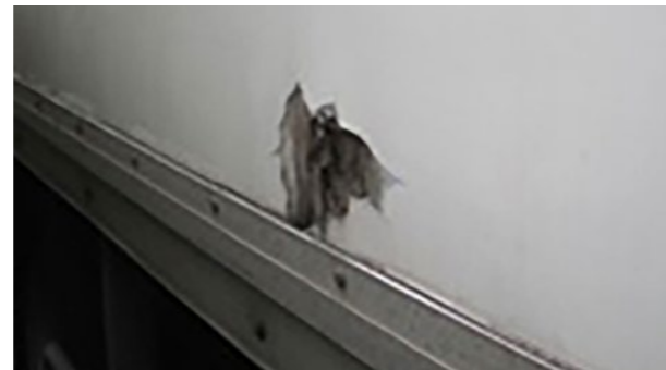
Sidepaneler i træ: Beskadiget træholder \geq 20 cm
