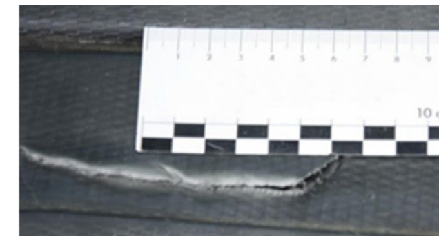
Huller i beklædningerne af hård plast. Reparation af beklædningerne af hård plast i times enhedsatts hvis æstetisk acceptabelt og reparerbart
