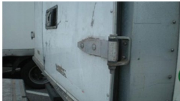
↻ Side- og bagdøre: Døre bøjedede ved fastgørelsespunkterne til hængslerne, brudt, hullet eller som ikke kan betale sig at reparere
