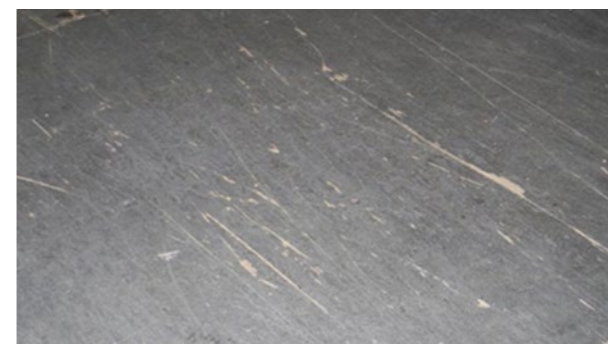
Gulvbelægning: Mindre deformationer, overfladisk slitage
