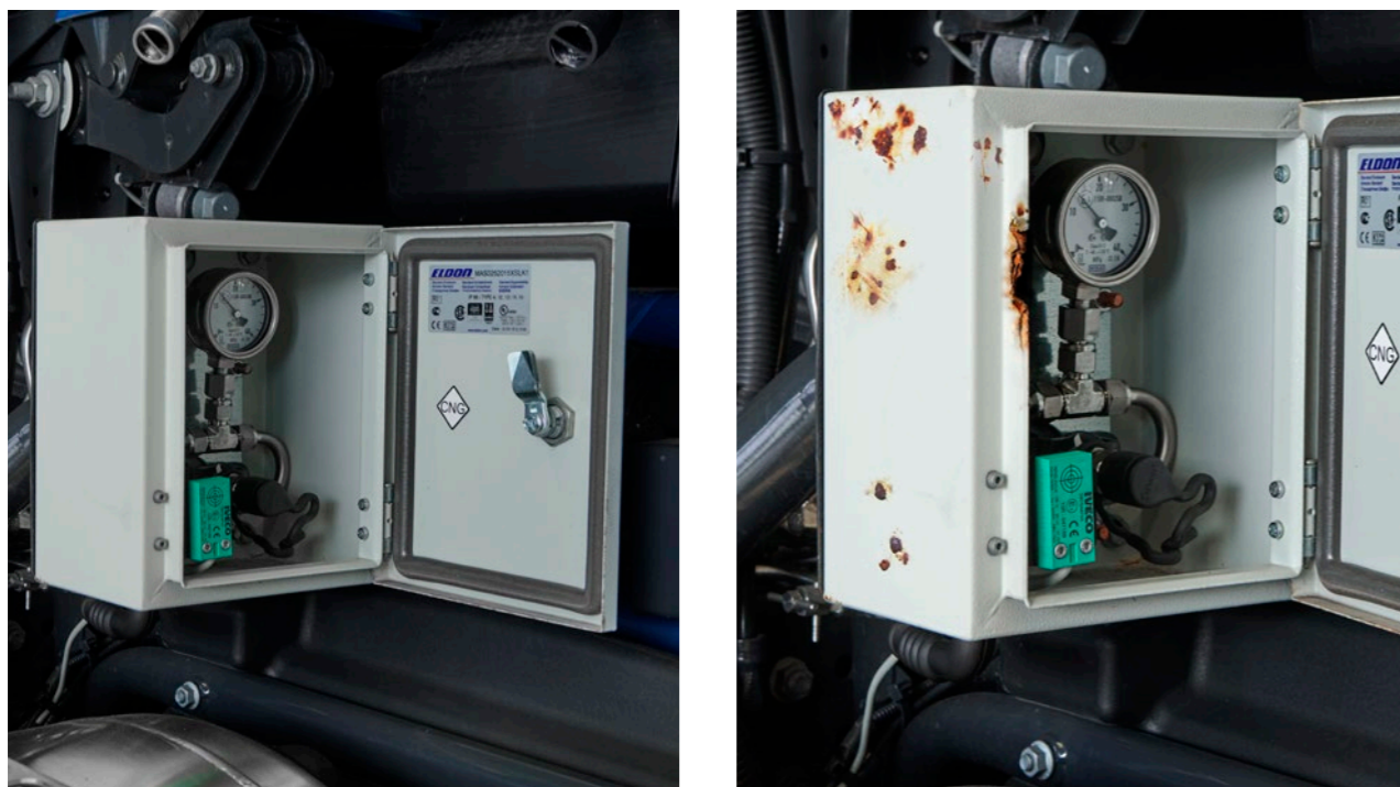
Rust på påfyldningsforbindelsens beskyttelsesboks → bemærkning uden beregning for skade.
